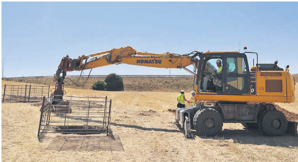
Las máquinas ya trabajan en la primera fase de los trabajos (foto: Ayto Arroyomolinos)
