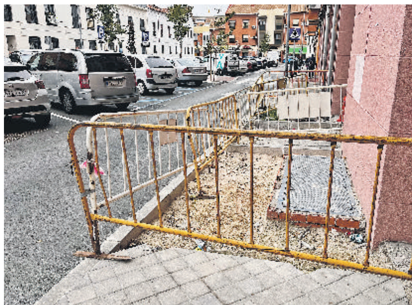
Este es el aspecto que tiene el acceso al centro de transformación de Iberdrola
