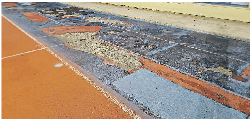
Estado que presenta una zona de las pistas del polideportivo San Domingo
