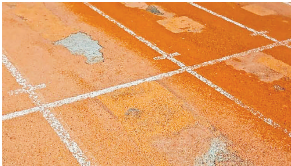
Aspecto que presenta la superficie de la pista de atletismo de Santo Domingo
